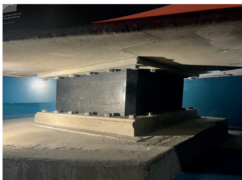
Wellingtonin kansallismuseon alla on paikallisen innovaation tuloksena asennettu ns. 'Quake braker'-eristäjiä, jotka koostuvat kumista ja teräksestä ja "eristävät" maanjäristyksiä ja vähentävät rakennusten heilumista.
